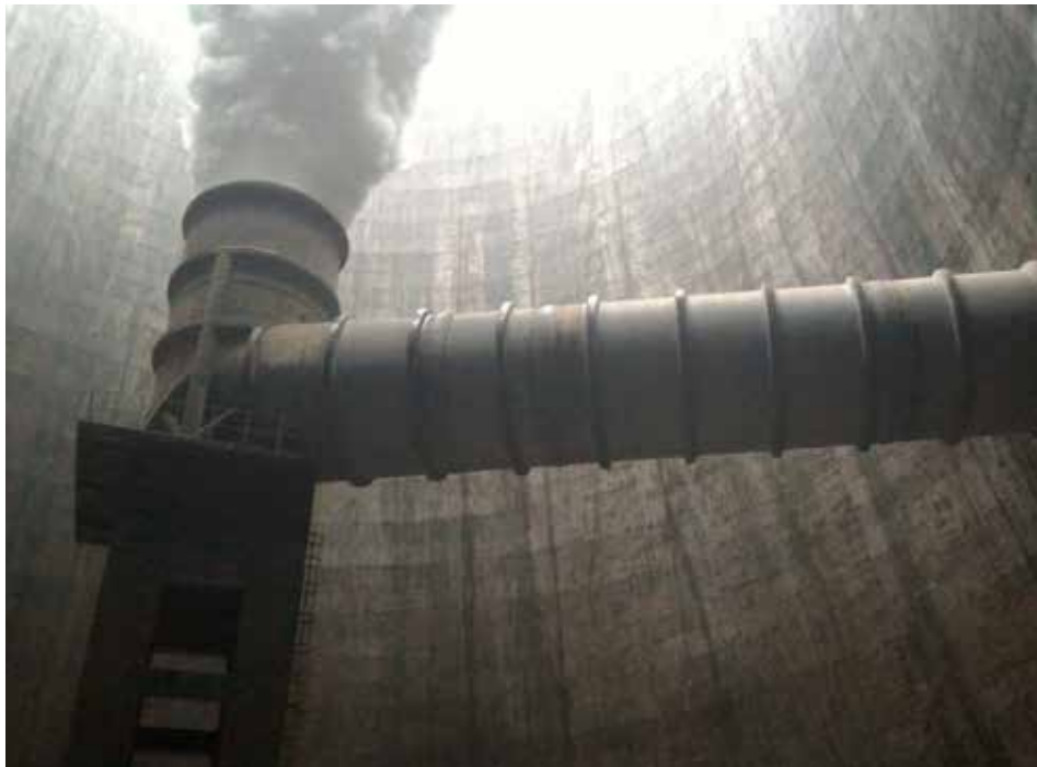
2015: Mittlerweile ist der Kühlturm sein fünf Jahren in Nutzung. Der Beton ist immer noch vollkommen unbeschädigt. Ein ausgezeichnetes Ergebnis.
